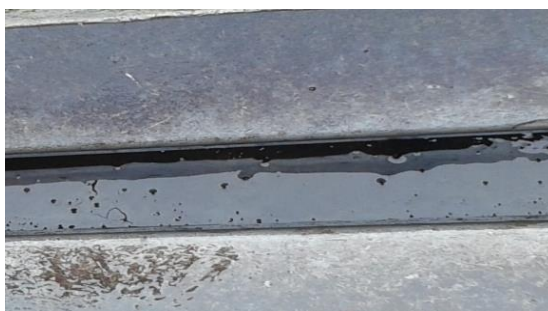
Figura 13 Excesso de desmoldante.
