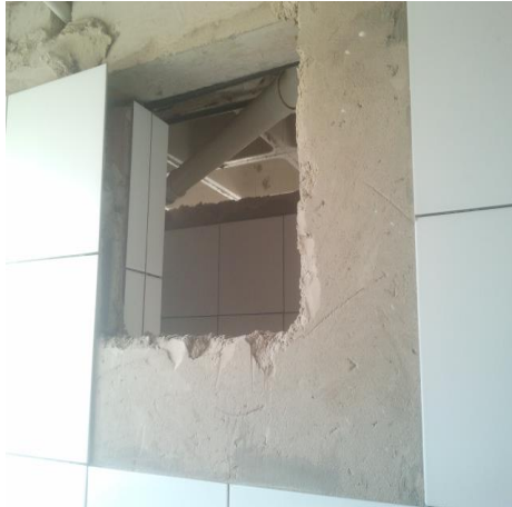
Figura 3- Erro de execução
