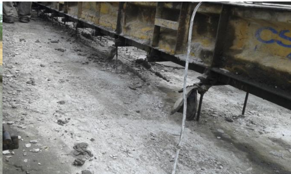
Figura 15 Forma com vedação falha.
