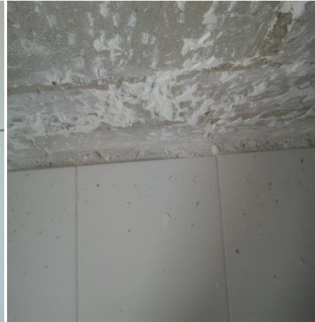
Figura 4- Erro de espessura do reboco
