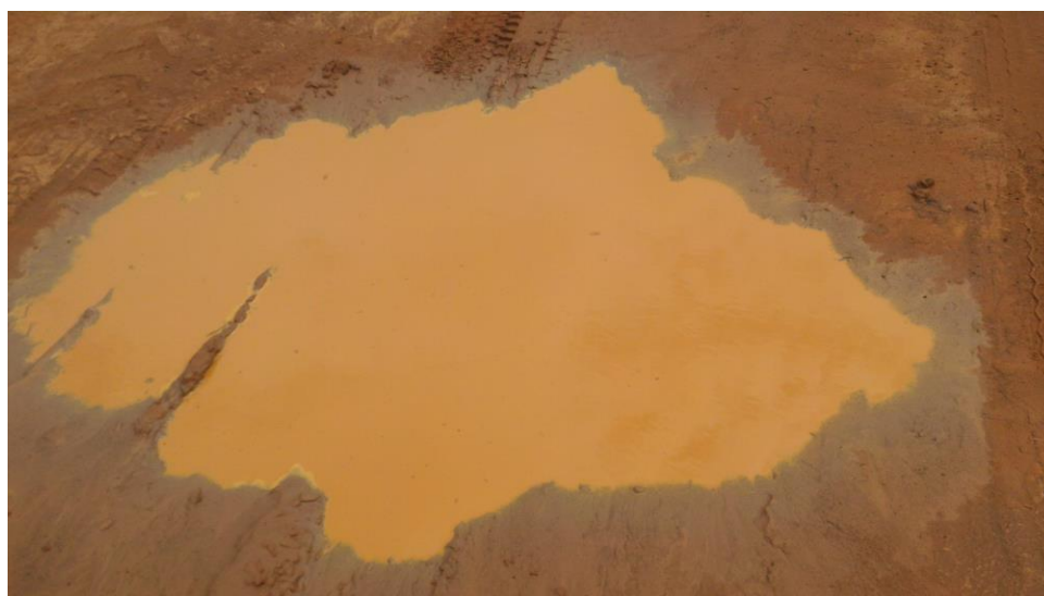
Figura 8 – Formação de buracos no eixo da pista.
