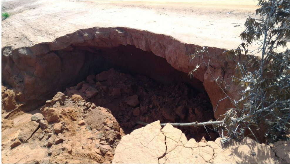
Figura 9 – Formação de grandes vazios no solo, conhecido como “sumidouros”. Fonte: O autor.
